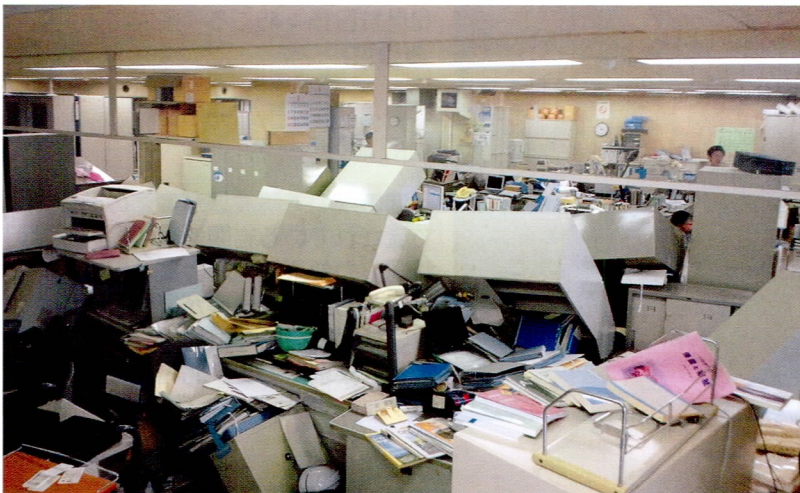
震度6弱の烈震で書棚などが倒れるなど、大きく被災したいわき市役所本庁舎。災害対策本部は、消防本部に置かざるを得ない事態に陥った (3月11日14:55ごろ)
