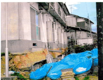
四倉の市営住宅梅ヶ丘団地では敷地内の一部が崩壊(4月27日)
