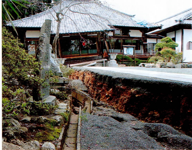
4月11・12日の震度6弱の直下型余震。断層が永い眠りから覚めてしまった。常磐藤原町の建徳寺境内の地割れ (5月2日 穴戸博氏提供)
