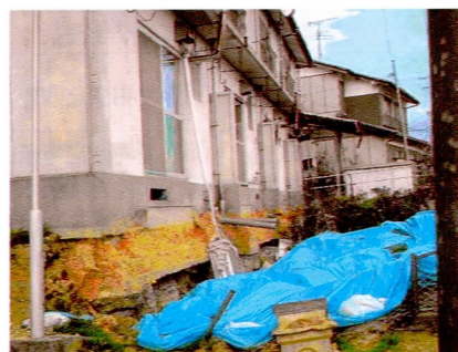
四仓的市营住宅梅筒丘团地内发生部分塌陷(4月27日)
