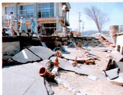
久之滨的荫矶桥，被海啸损毁裸露在外的自来水管(4月14日)
