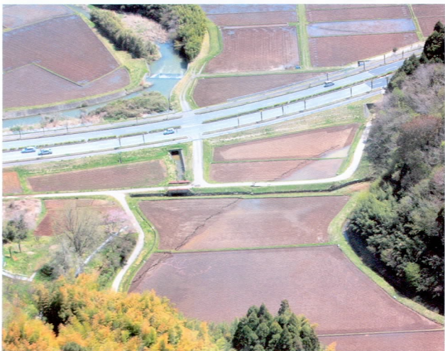
主要地方道路磐城石川线常磐藤原町地段附近。在水田发生地裂，简易铺装的道路发生颜色变异
