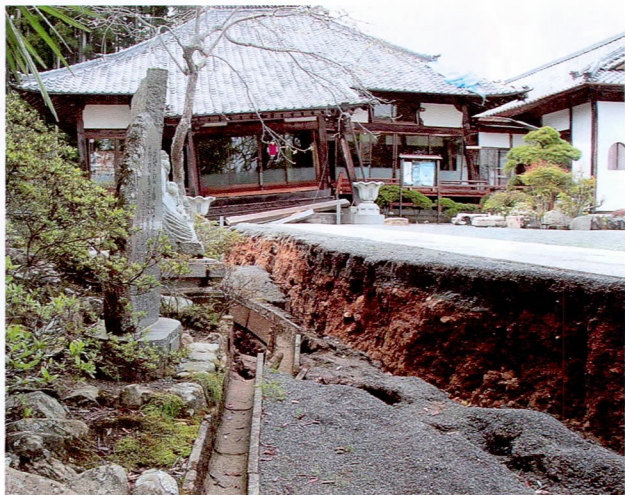
4月11·12日所发生的震级6弱的直下型余震。断层从长眠中觉醒。常磐藤原町建德寺境内的地裂
