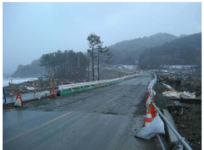
▲As合材が不足しているため砕石で 応急復旧した路面(岩手県大槌町)
