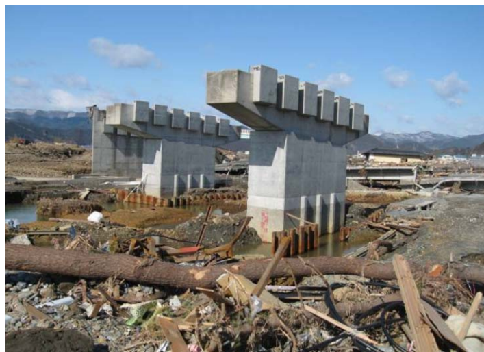
▲沼田跨線橋(上部工流出)
