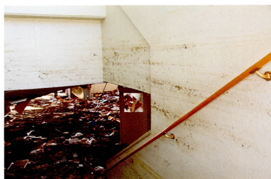
1階天井にまで津波の痕跡がみられる漁協事務所
