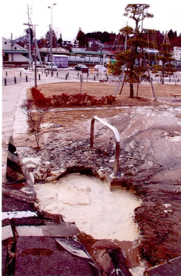
地震による水道管の漏水被害状況 三沢駅東口
