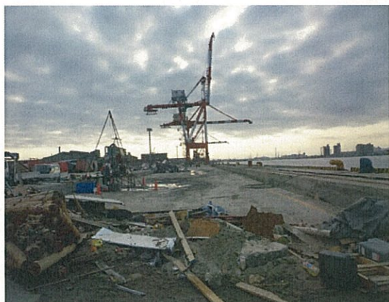
被災状況（平成 23 年 4 月 18 日時点）
