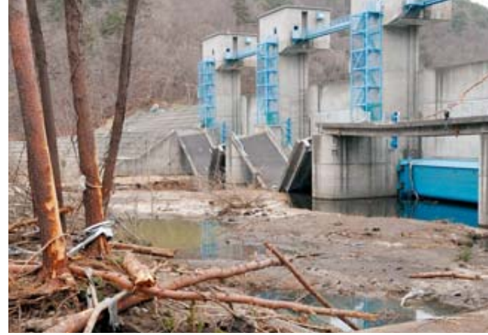
15.5mの水門を超えた津波の威力で水門が破損（20日午後3時38分）
