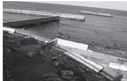
鹿糠漁港 (玉川)。護岸が損壊 (12日、14時53分)
