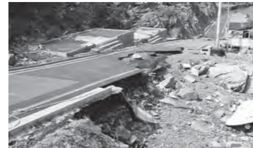
崩壊した道路 (13日、12時06分)
