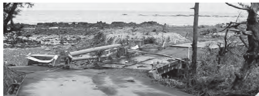
損壊した和座川橋 (11日、17時04分) ※現在は通行可
