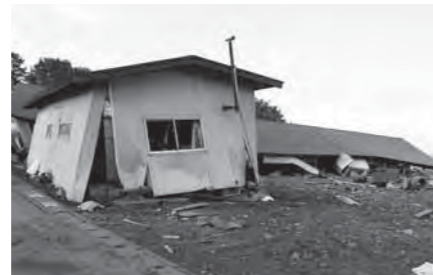
鹿糠漁港 (鹿糠)。損壊した付近の建物 (12日、14時42分)
