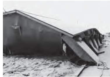
損壊した建物 (12日、6時28分)
