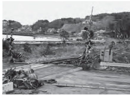
JR八戸線の線路が流出。踏切も損壊（12日、9時34分）
