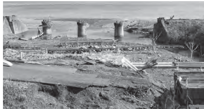
JR八戸線の鉄橋、町道大浜八木線の橋が崩壊（12日、9時17分）
