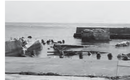
損壊した防波堤 (13日、10時55分)
