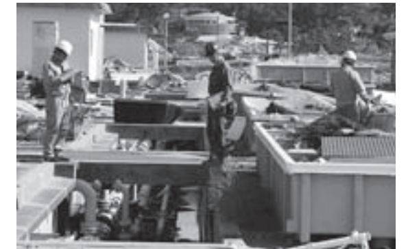
業者による施設の被害状況調査
