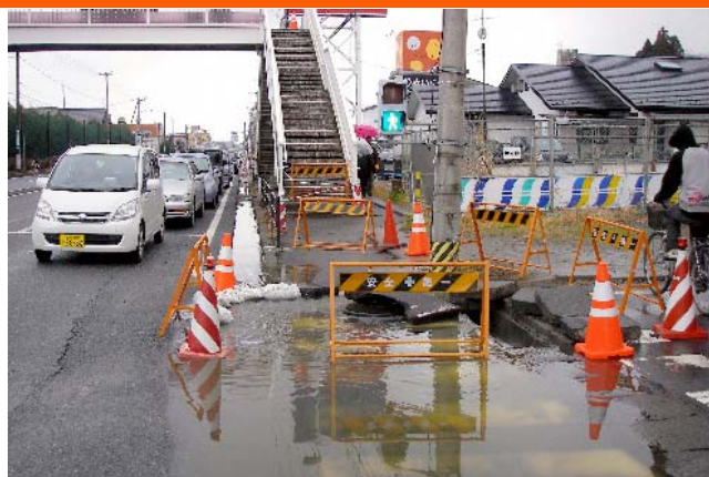
道路に汚水が溢れる
