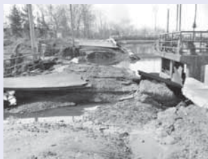
▶仙塩浄化センター被災状況
