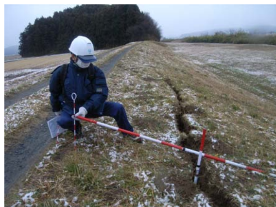
3/16 旧北上川支川(江合川) 被災状況調査
