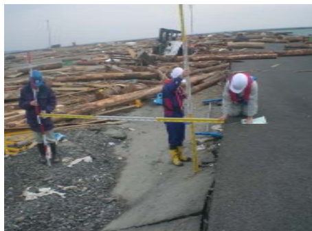
石巻港 被災状況調査
