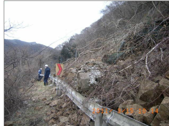
3/15 国道被災状況調査・迂回路調査
