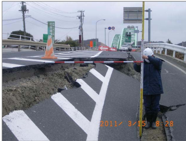
3/15 国道45号被災状況調査
