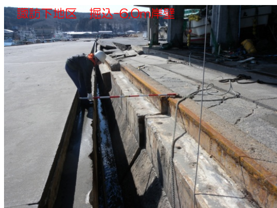
掘込-6.0m岸壁 棧橋構造の渡橋版の流出、護岸の移動が発生
