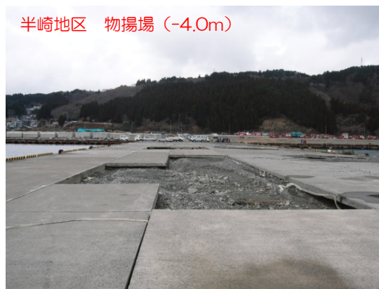
半崎地区 物揚場 (-4.0m) コンクリート版の沈下・剥離、流出が発生
