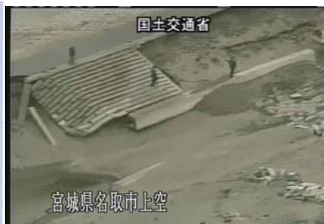
宮城県名取市の海岸堤防の被災状況
