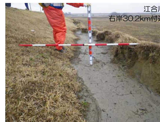
液状化現象による噴砂の状況
