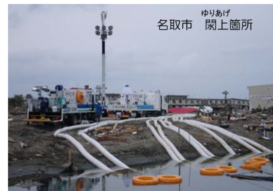
排水ポンプ車により津波で 貯まった水を川や海に排水
